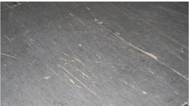
Plancher: déformations légères, usure superficielle
