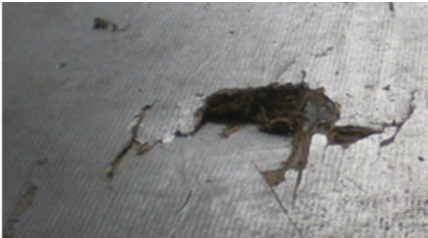
Plancher: déformations ou perforations dans la limite économique de la réparation
