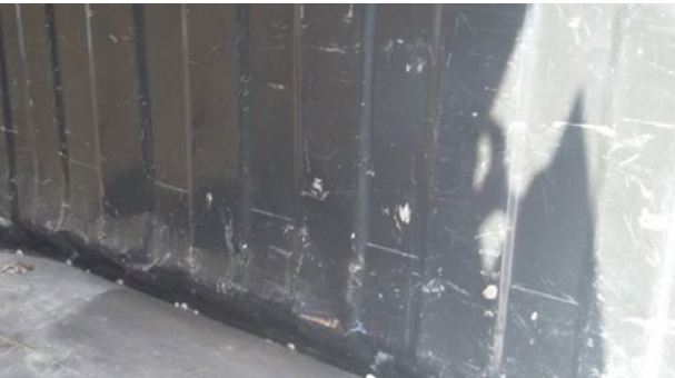
Déformations intérieures: Déformations légères sans perforation ou découpes et dont le temps de réparation est \leq 3h
